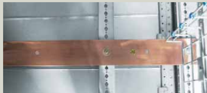
Главная заземляющая медная шина в нижней части шкафа
