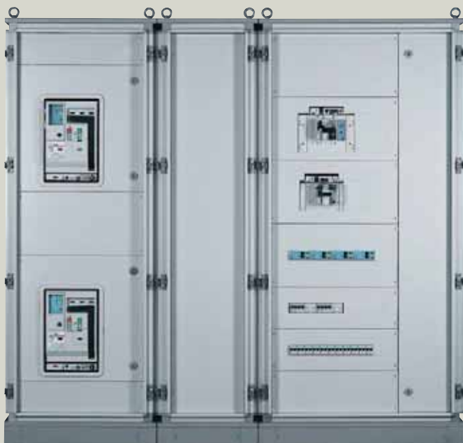
Щит шкафной на 4000 А с устройством ввода резервного питания на базе выключателей DMX
