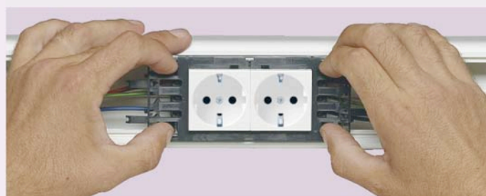
Монтаж розеток Mosaic в кабель-каналы DLP
